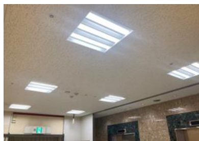
バトリア東大宮 (さいたま市見沼区) EVホール
